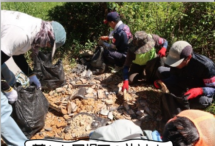
落ちた屋根瓦の片付け
